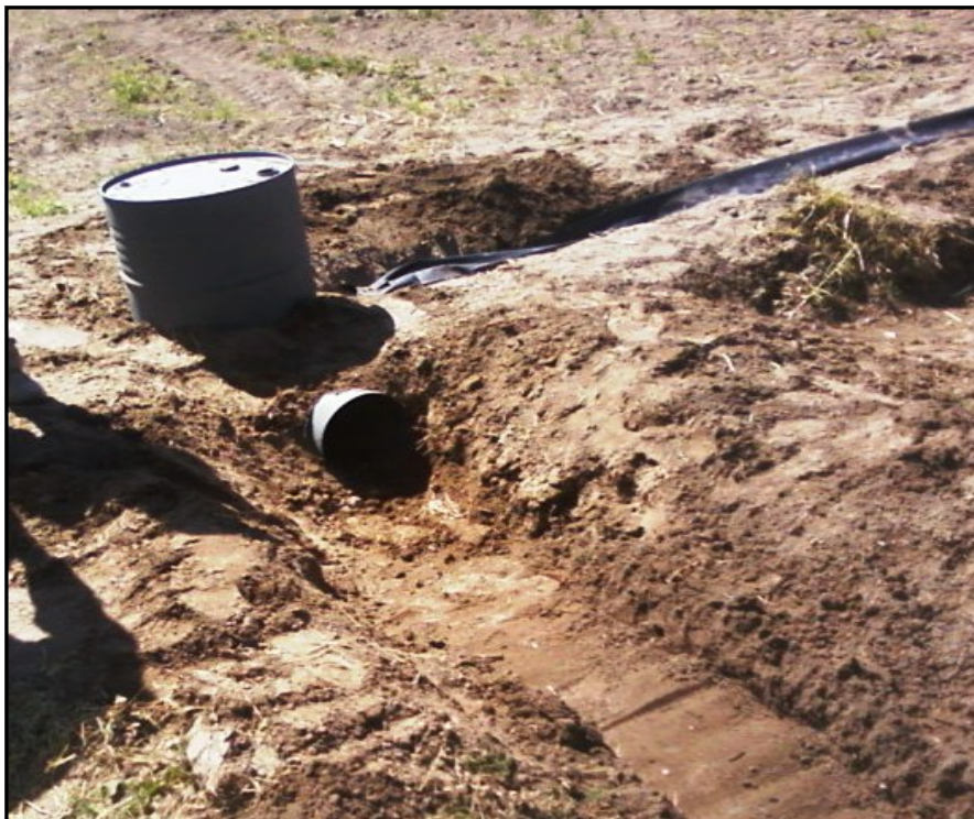
Fig 4. Derivación con tambor en codo desde acequia a la manga en cabecera
